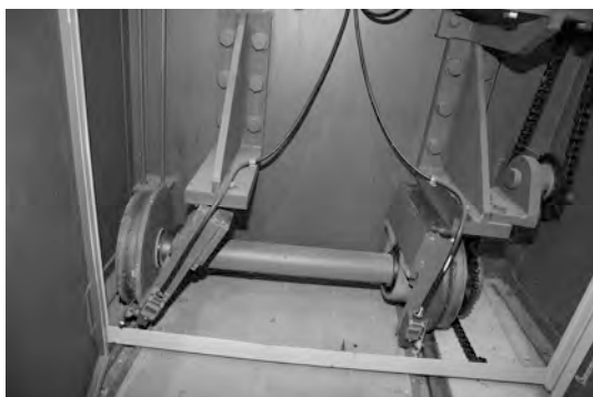
シールド扉駆動系破損
