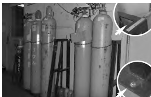
サイクロ棟 (管理区域2階通路)
