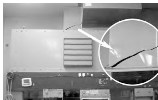
ホットセル排気ダクト
